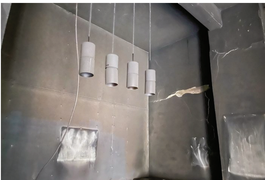
1 | Blick auf den Brandschaden
