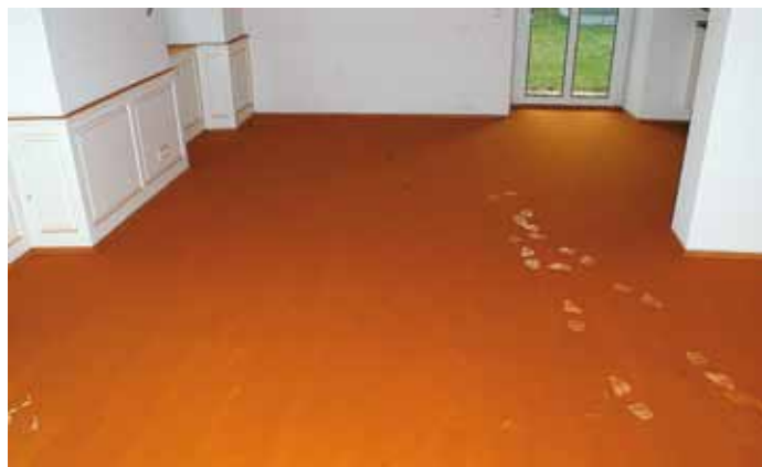
Die Hausschwammsporen bedecken den gesamten Fußboden und alle waagrecht abstehenden Flächen
