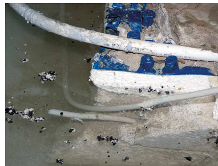
Abb. 13: Biozide Spülungen können gerade bei Fußbodenheizungen immense Rückbaukosten ersparen.
