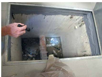
Abb. 4: Eine Begehung des zu sanierenden Objekts ist im Vorfeld unerlässlich. Hier im Bild ein Revisionsschacht, der vor der bioziden Spülung am oberen Rand abgedichtet wurde.
