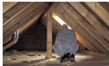
Schimmelpilz befallene Dachstühle müssen im Regelfall nicht abgerissen werden
